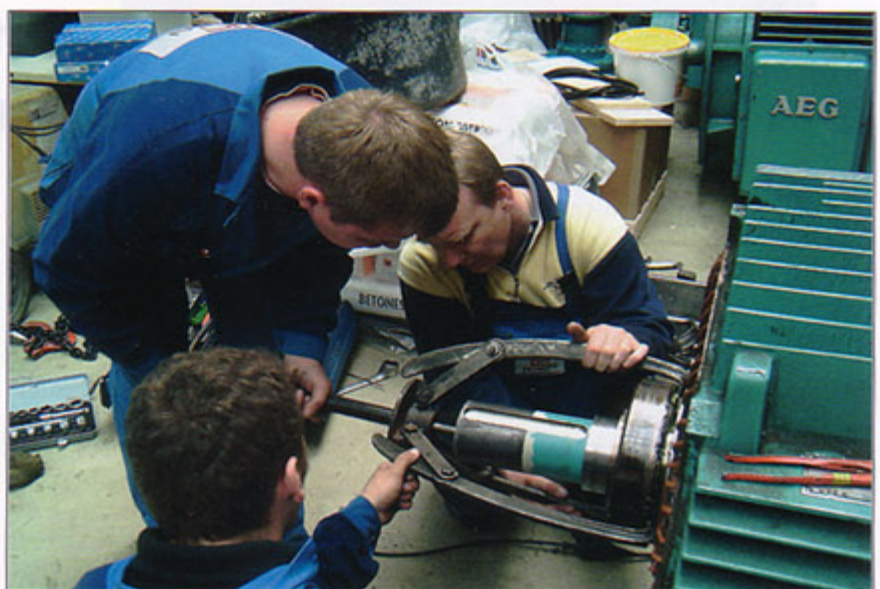
Neue Generatorlager, anderes Fett
